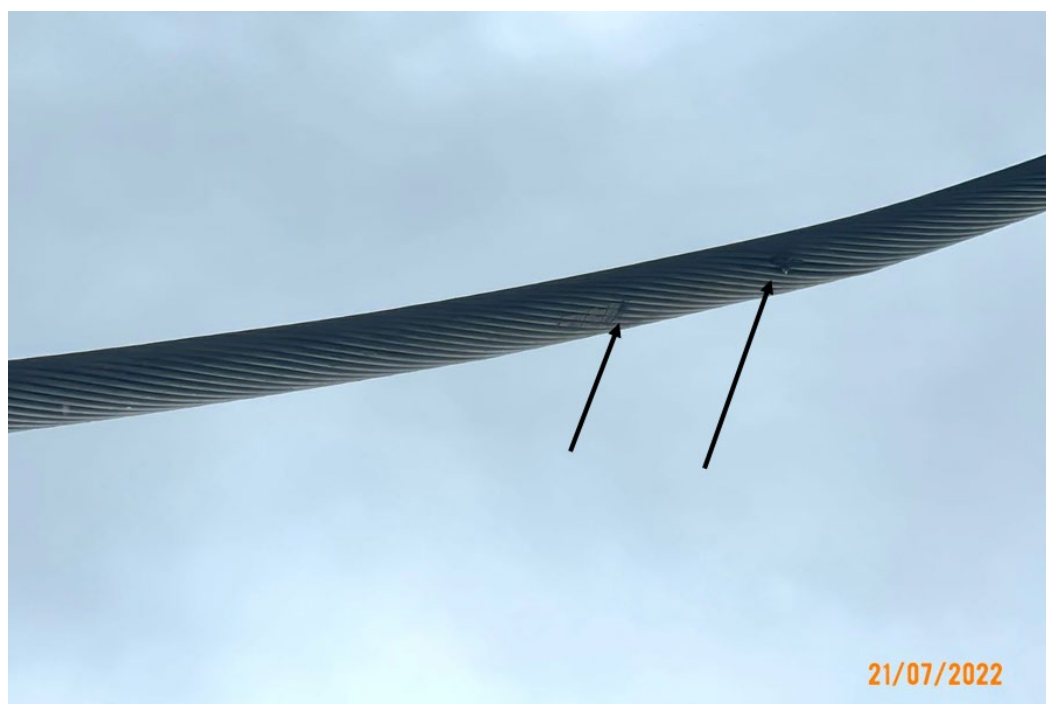
Рис. 3. Следы КЗ на проводе ВЛ 220 кВ Новокиевка - Февральская
